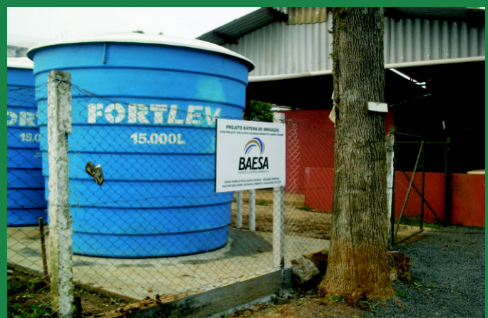
Sistema de irrigação e captação da água da chuva foi implantado com recursos da BAESA
